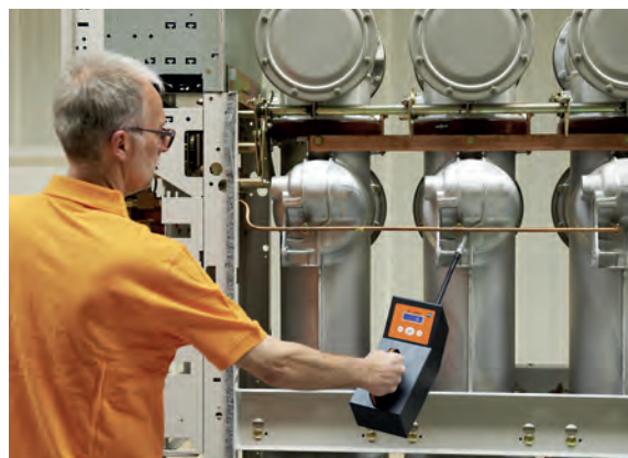
El aparato SF 6 -LeakSpy permite detectar y cuantificar las concentraciones más pequeñas de SF 6 (resolución 1 ppm v )
